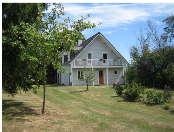
Faitage non parallèle à la voie, rue du Bourville
